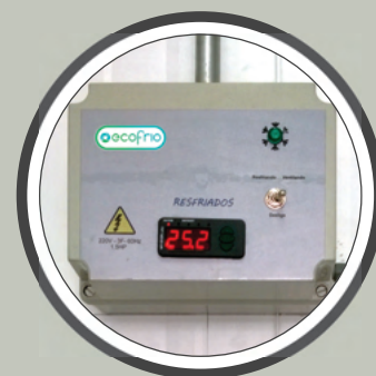
Quadro de Comando
